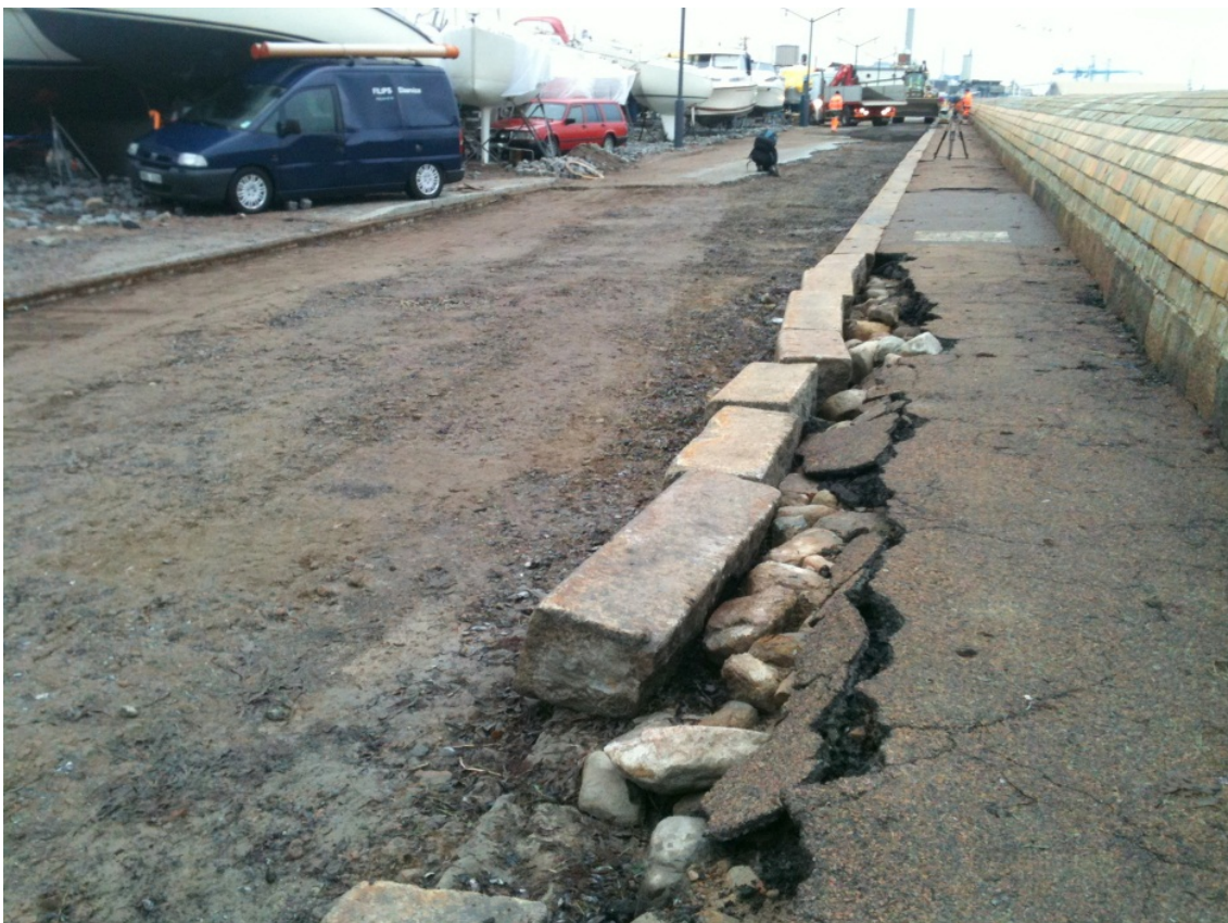
Figur 6-5. Skador på Parapeten i Helsingborg. Skyddsmuren till höger på drygt 4 m räckte inte till för krafterna i vågorna vid adventsstormens höga vattenstånd och kraftiga vindar. Bilar som stod parkerade vid trottoaren flyttades över vägen in i båtar. Kullerstenen spolades bort. Foto: Widar Narvelo, Helsingborgs stad.
